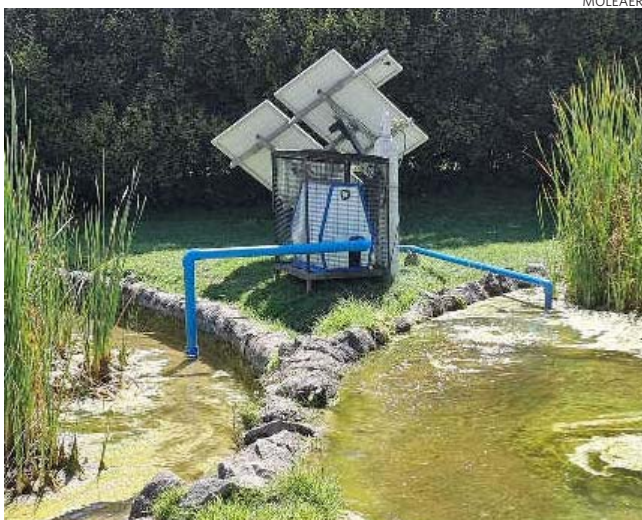
Las nanoburbujas se deben instalar idealmente al lado del tranque para aprovechar sus beneficios.
